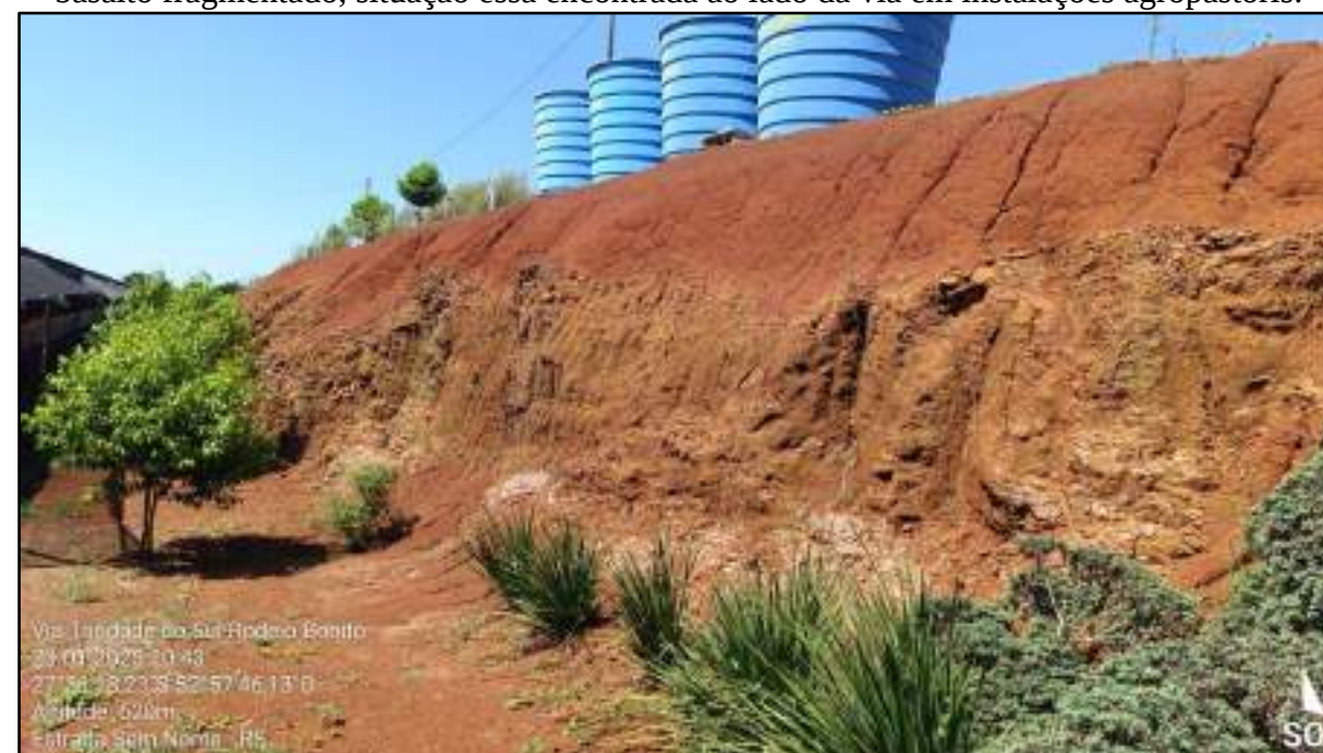
Figura 37.: Cama de solo exposto de cerca de 1,0 metro, onde abaixo é possível observar porções de basalto fragmentado, situação essa encontrada ao lado da via em instalações agropastoris.
